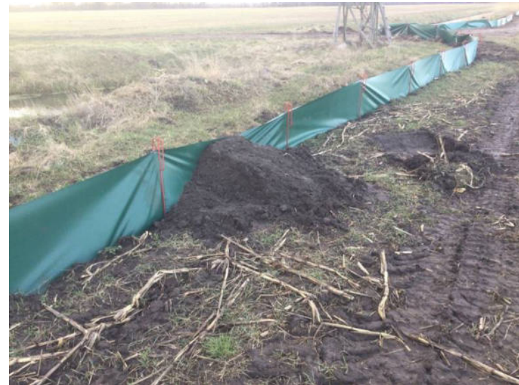
Abb. 21. „Rampe“ an einem Schutzzaun.
