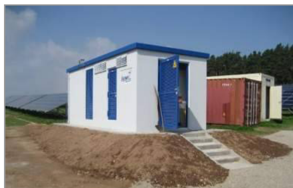
Beispiel_ Wechselrichter (Trafostation) mit Ölauffangwanne
